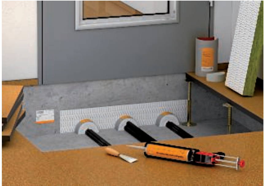
Kuva: Kaksoislattian ja pako- ja pelastustien liitoskohta PYROCOMB® Intube CTS-HP200 palokatkoilla
